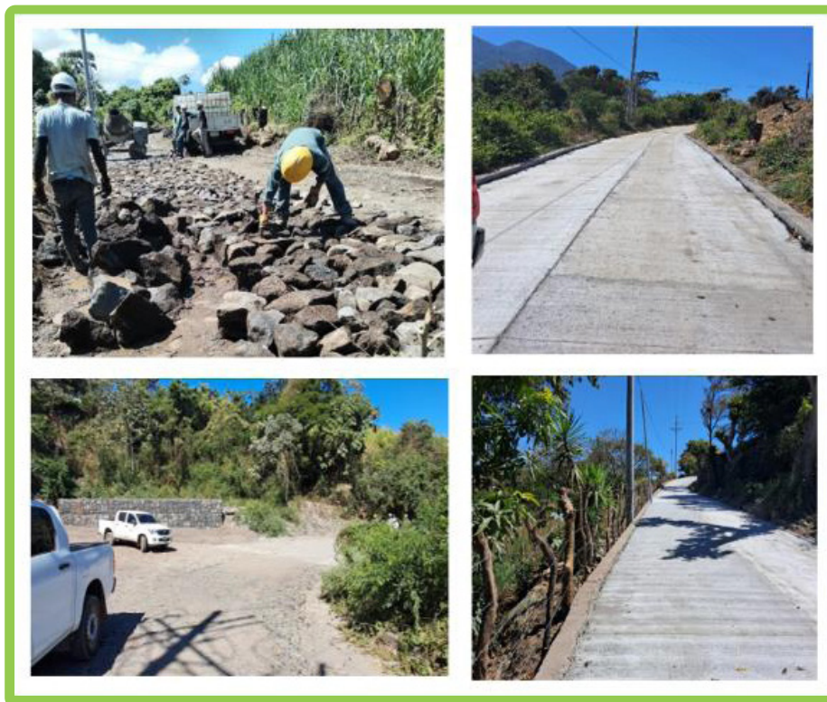
Construcción y reparación de tramos de calle de acceso a plataforma SV-5 y obras complementarias.
